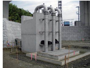
調整池のバルブピット
