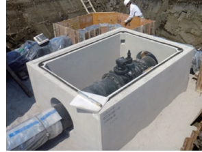
上水道バルブピット内蔵
